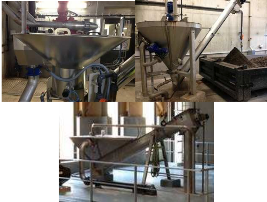
Figure 20 : Laveurs à sables des stations d'épuration de Saint Marcellin, Saint Nazaire en Royans et Villard de Lans
